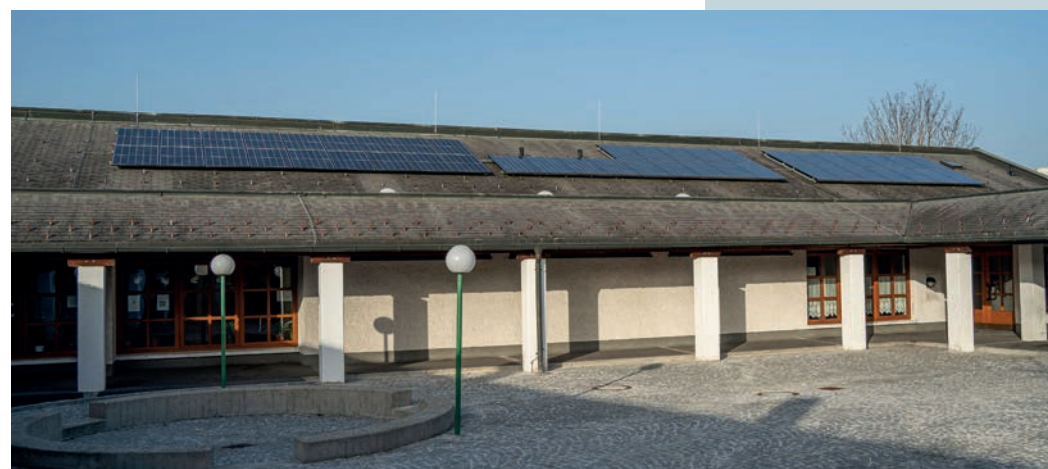
Die neue Photovoltaikanlage zur Versorgung mit Strom wurde in Betrieb genommen.
